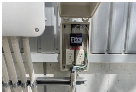
《標準装備している予備電源の一例》
